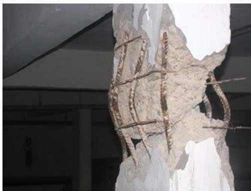
Figura 1.2 – Ruptura na extremidade do pilar em um edifício
